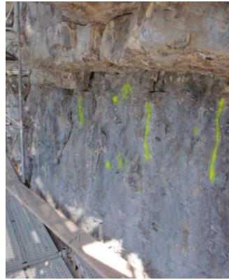
3 Die Risiken bei Arbeiten im Bereich von Naturgefahren sind ständig neu zu beurteilen (z.B. absturzgefährdete Felspartien).
